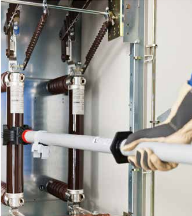
Bild 5-9: Wechsel einer HH-Sicherung mit vorschriftsmäßiger Sicherungszange
